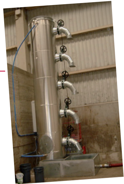
Tubo ensayo de decantación Proyecto INDALOS (Planta de Vitoria)
