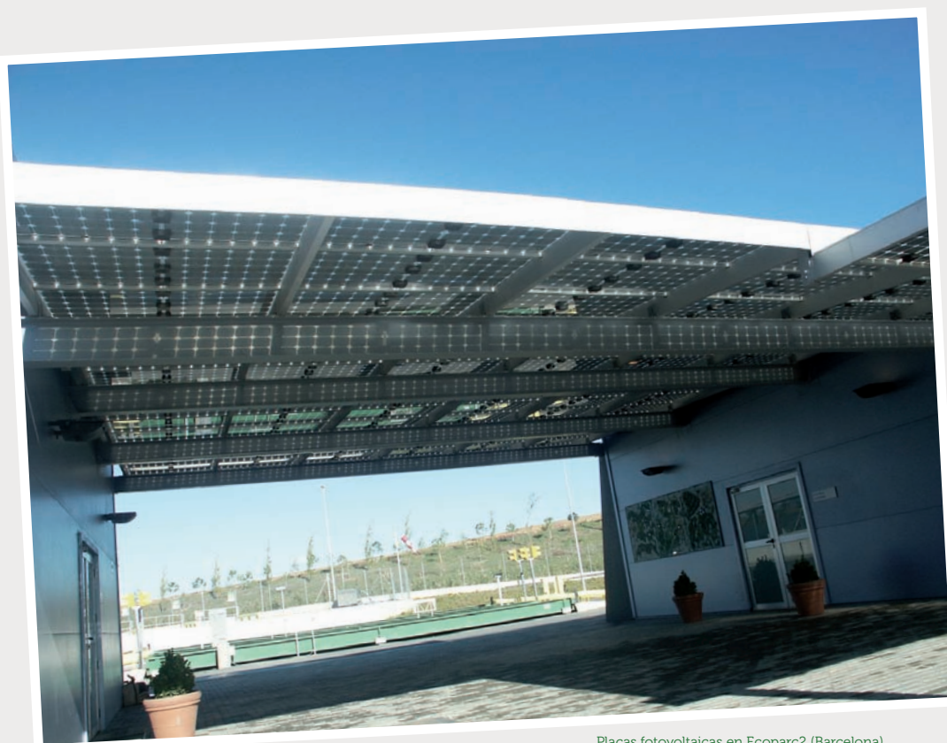
Placas fotovoltaicas en Ecoparc2 (Barcelona)
