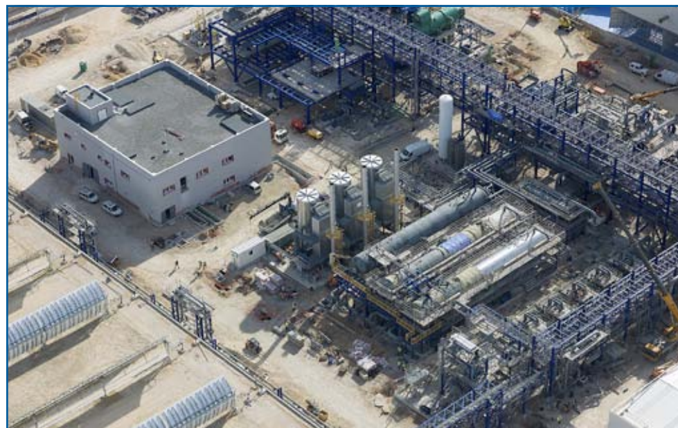
Palma del Río Solar Thermal Plant, Córdoba
