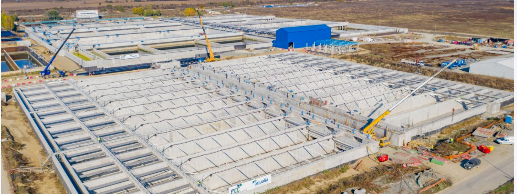
Glina WTP / Rumania
