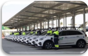
Estación de recarga de Vehículos híbridos en el Parque Central
